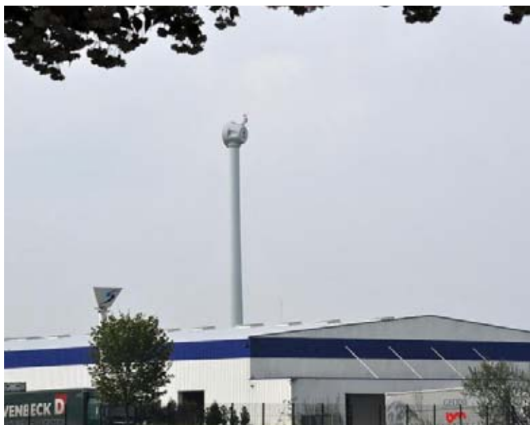
Les trois pales de l'éolienne ont été démontées le 21 mai. Elles ne seront pas remontées avant plusieurs mois. PHOTO BRUNO FAVA
