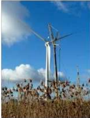
Eolienne DDIS60 installée sur la commune d'Onnaing dans le Nord. DR
